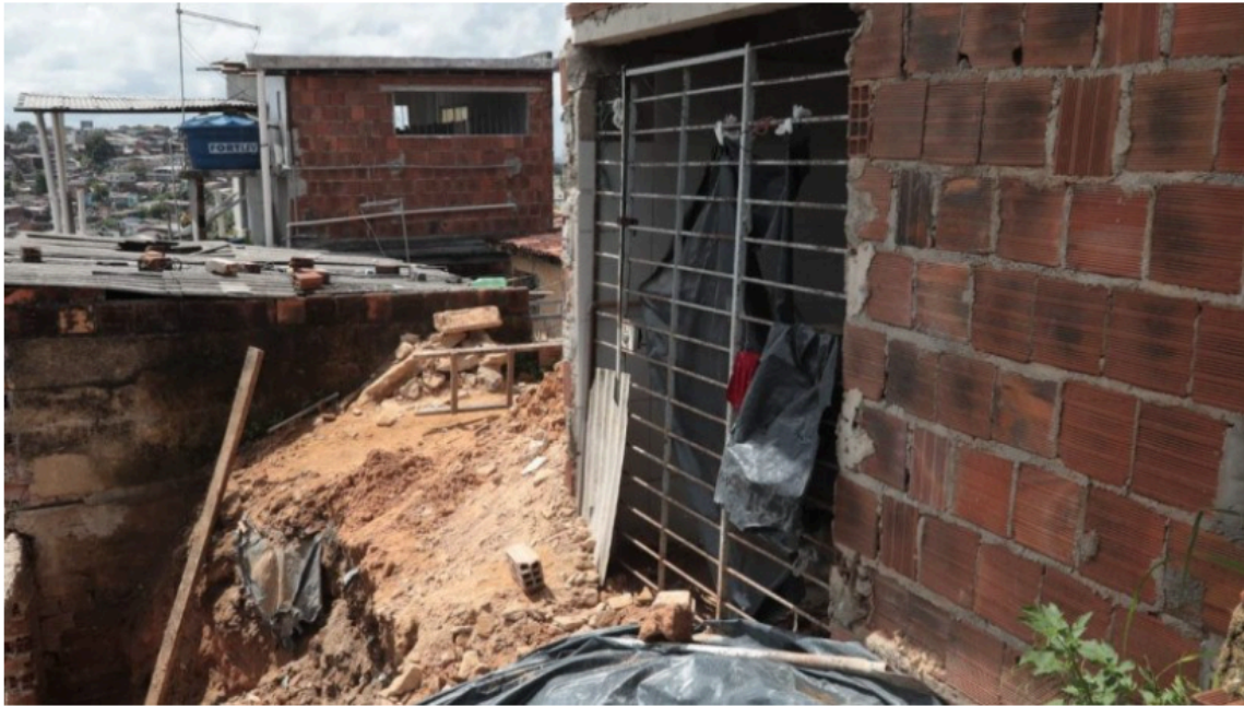
A vítima estava derrubando um muro construído por populares para possibilitar obras na encosta - GABRIEL FEIRREIRA/JC IMAGEM
